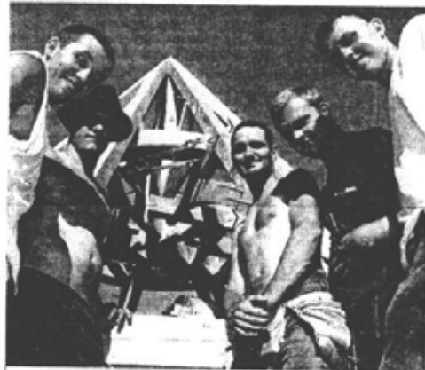
Cinq jeunes charpentiers (l'un est absent), sous la tutelle de Jérôme Talenton, passent trois semaines à restaurer le moulin de Grateloup PHOTO D.A.
